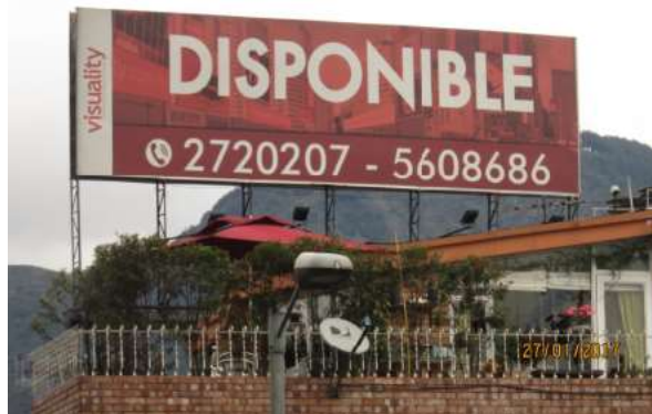
FOTOGRAFIA 2: Foto del tablero de la valla tubular, la cual no cuenta con registro.
